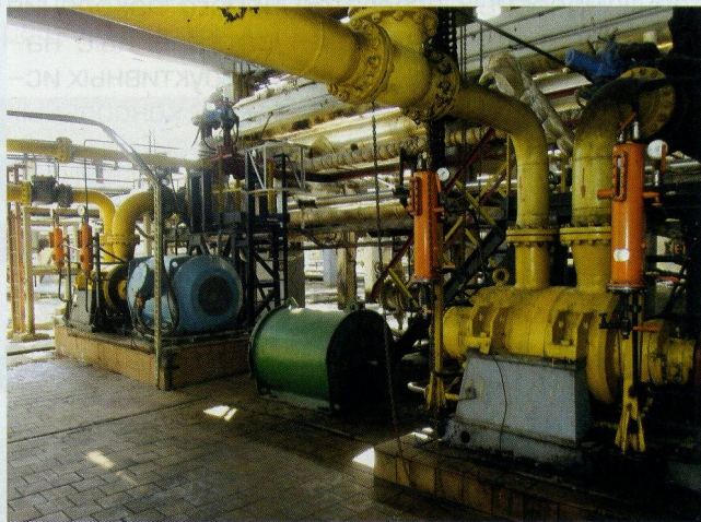
Рис. 3. После реконструкции установки «Дуосол-22»
