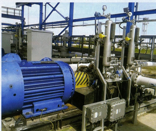
Рис. 3. Насосные агрегаты АНДМс 250–480 в насосной станции МНПП
