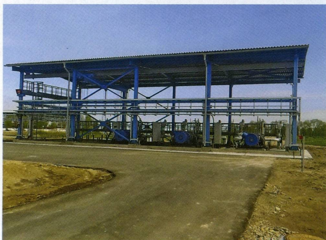
Рис. 2. Насосная станция МНПП
